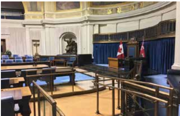
Rampes d'accès pour fauteuils roulants
